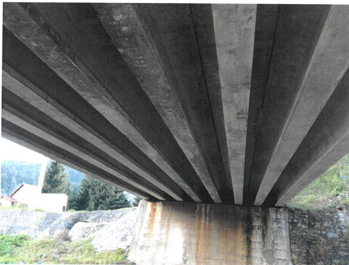
Foto nr. 3 – Defecte de suprafață ale feței văzute (culoare neuniformă, pete negre, impurități, pete de rugină, aspect prăfuit, imperfecțiuni geometrice, aspect macroporos, agregate la suprafață).
