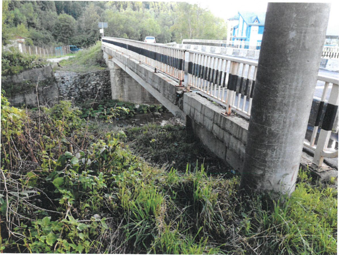
Foto nr. 15 – Lipsa sau degradarea parapetului de siguranță și/sau a unor elemente din parapetul podului
