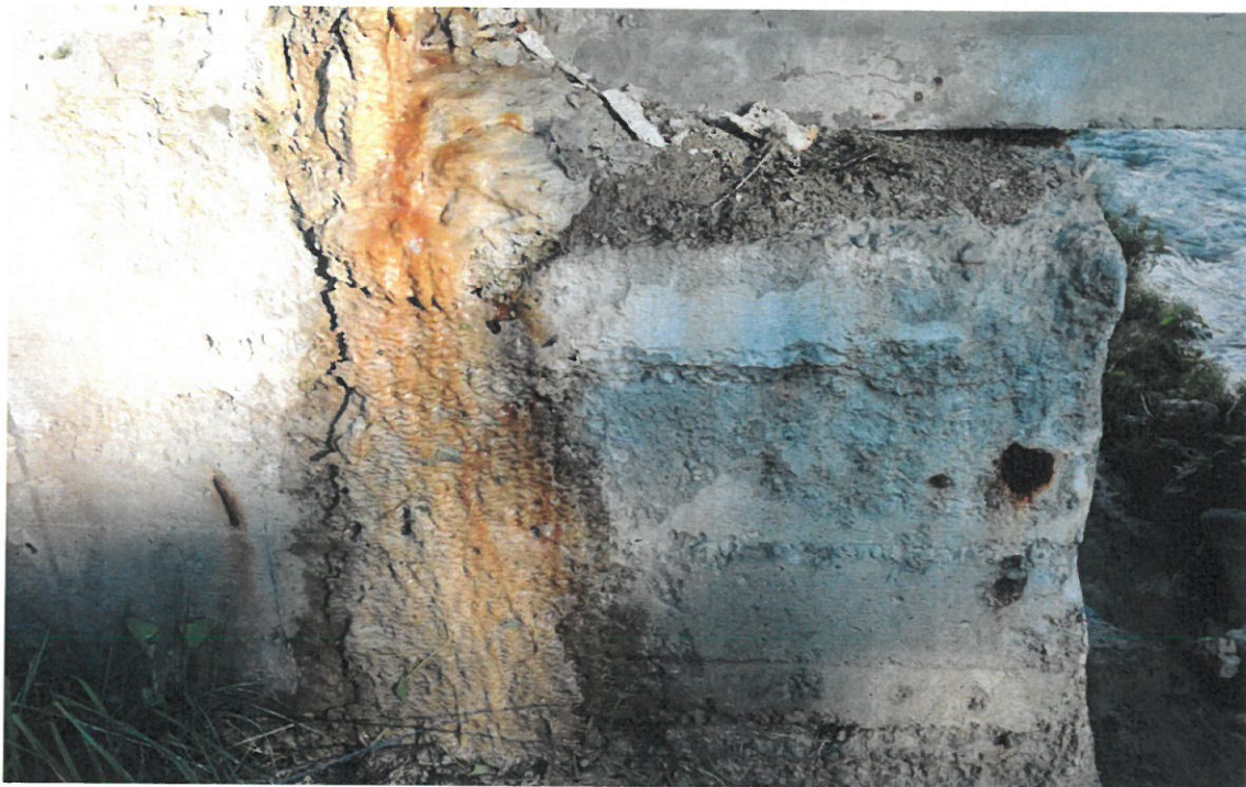
Foto nr. 5 - Aparate de reazem înglobate în praf și murdărie, nefuncționarea corespunzătoare a acestora
