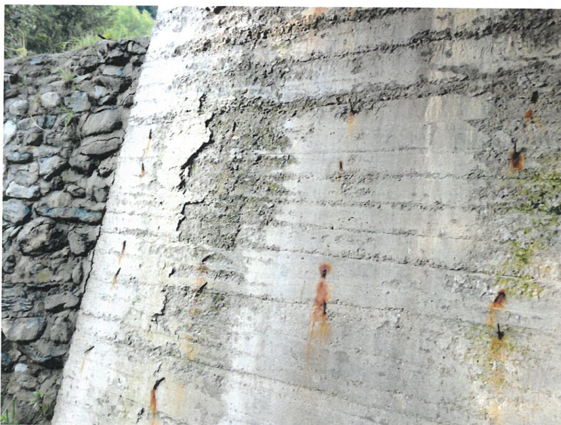
Foto nr. 8 – Cumularea la un element al structurii a mai multor degradări (coroziunea betonului și a armăturii, exfoliere, fisuri, crăpături, striviri) care se manifestă prin modificarea formei elementului și a proprietăților fizico-mecanice ale materialelor
