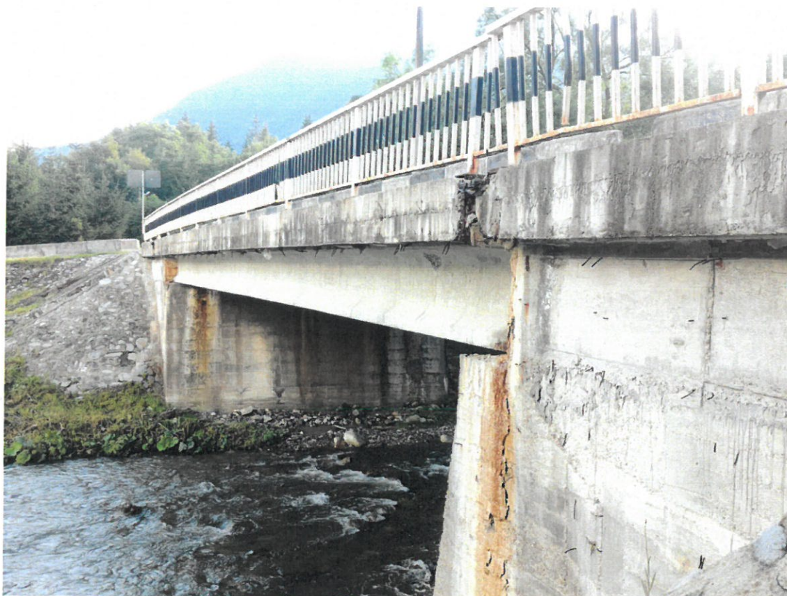
Foto nr. 9 – Lipsa dispozitivelor de protecție la acțiuni seismice
