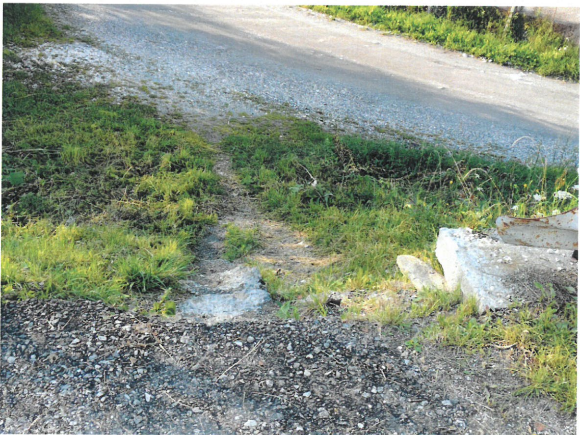
Foto nr. 18 – Lipsa sau degradarea lucrărilor de protecție a taluzurilor, scărilor de acces, casiuilor, racordare defectuoasă casiu cu bordura de pe culee
