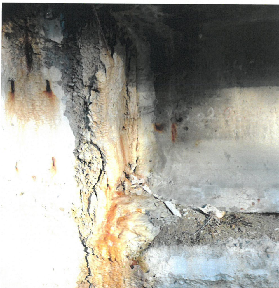
Foto nr. 6 – Blocarea aparatelor de reazem (blocarea deplasării suprastructurii datorită depunerilor și degradării beronului din zidul de gardă)
